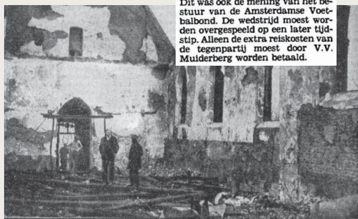
De Ned. Hervormde kerk te Muiderberg, die door brand geheel verwoest werd.
